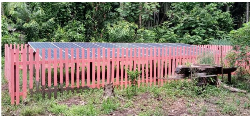
Figura 3: Pannel solar instalado na Resex Médio Juruá, Amazonas, Brasil, 2022.
